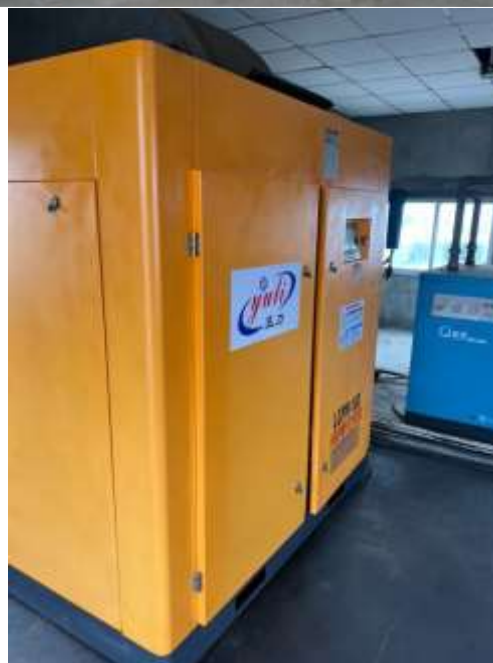
1台75kW及1台132kW 永磁電機及變頻的空氣壓縮機
